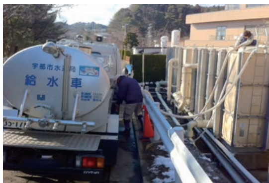
写真 受水槽への給水風景（宇部市水道局ホームページより）
