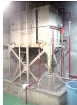
写真1(a) 非常用発電機のサービスタンク
