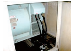
写真1(c) 非常用発電機のジェネレーター
