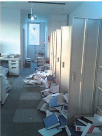
写真1 震災後の事務室 (棚から書類が落ち、散乱している)
