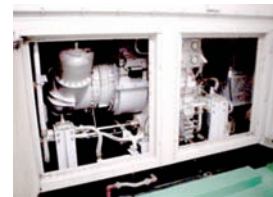
写真1(b) 非常用発電機のジェットエンジン
